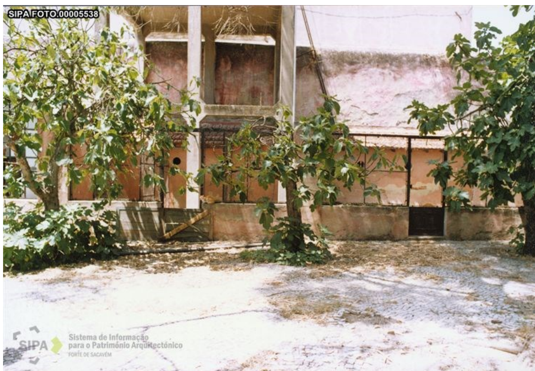
Anexo 18 – Vista do reservatório de água, Alcântara, Teresa Vale e Carlos Gomes, 1993, João Marques e Ricardo Porfírio, 2003
