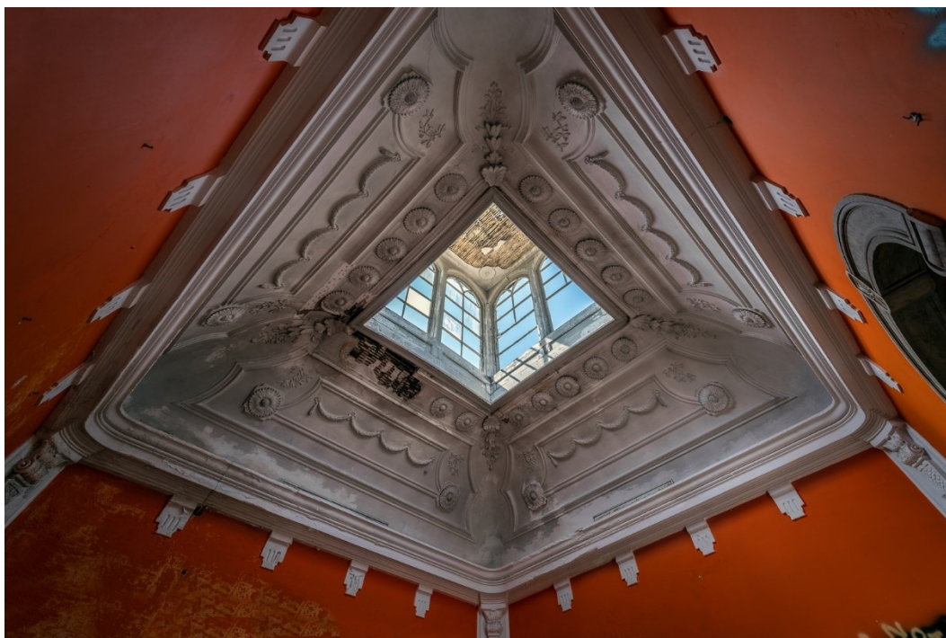
Anexo 50 – Vista do poço de luz no cimo das escadas principais do Palácio, Alcântara, Blog Abandonados, 2019
