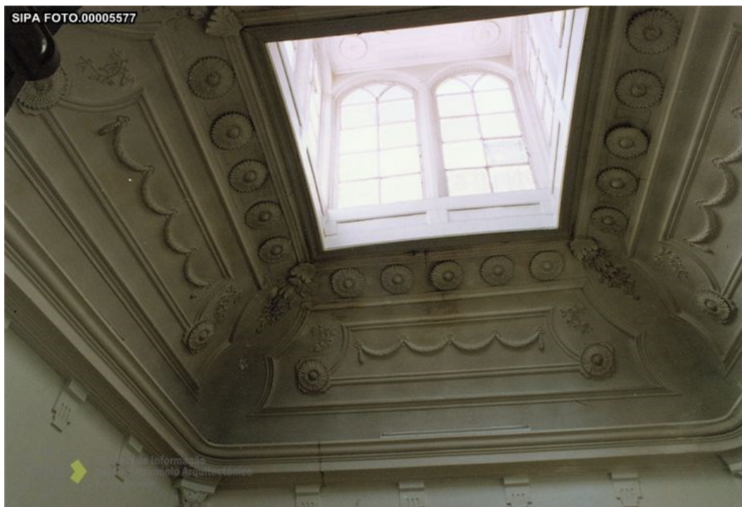
Anexo 28 – Poço de luz por cima da escada principal do Palácio, Alcântara, Teresa Vale e Carlos Gomes, 1993, João Marques e Ricardo Porfírio, 2003
